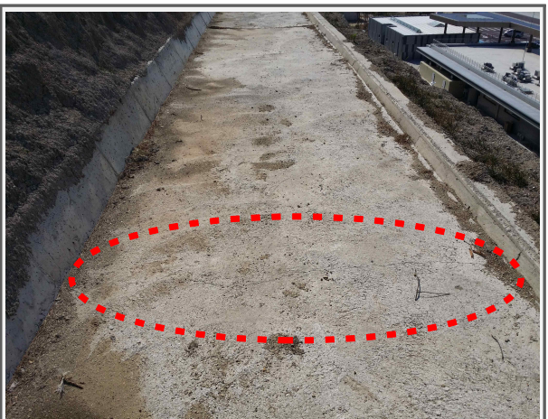
⑥ 20m 소단 종방향 균열 발생
