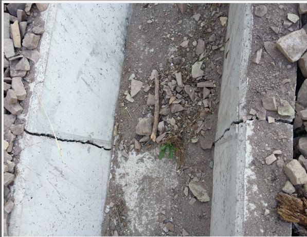
⑦ 산마루 측구 배수로 균열발생
